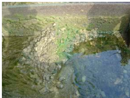
Feinsedimentablagerungen und Auflandungen in einem Beckenfischpass
