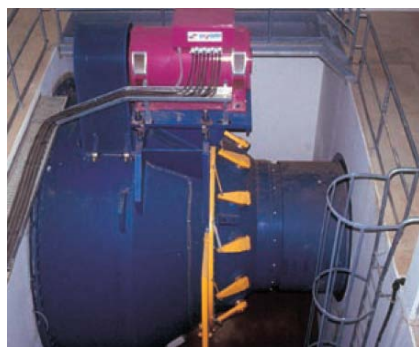
Kaplan-Rohrturbine mit Riemetrieb zum aufgesetzten Generator
